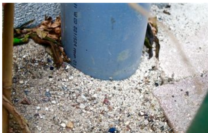
Et radonsug, her i form af udvendig rørføring, er en af de mest anbefalede måder, for at reducerer radon i kælderen. Foto: Pia Konstantin Berg
