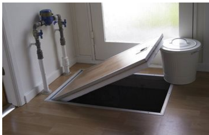
Sørg for at krybekælderen er tilstrækkeligt ventileret. Arkivfoto.
