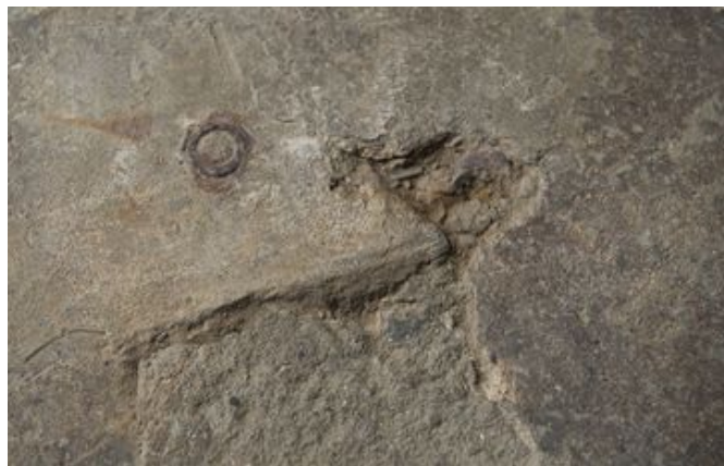
Revner i kælderen kan være skyld i, at der kommer større mængder radon ind i boligen. Foto: Torben Klint
