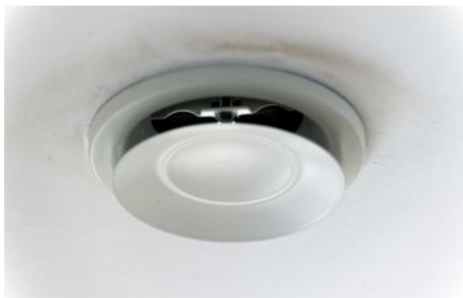
En løsning kan også være at sørge for god ventilation til kælderen. Arkivfoto.
